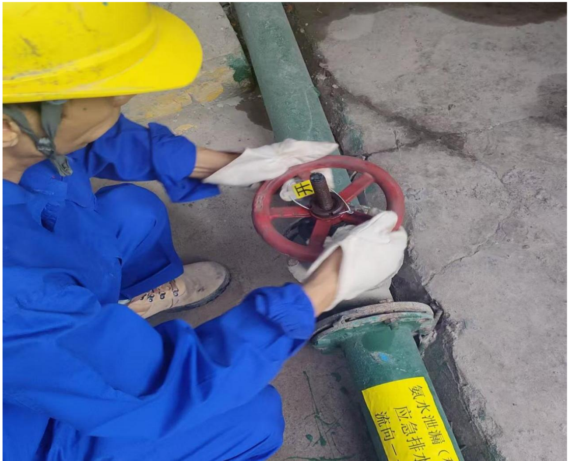
开启应急排水管阀
