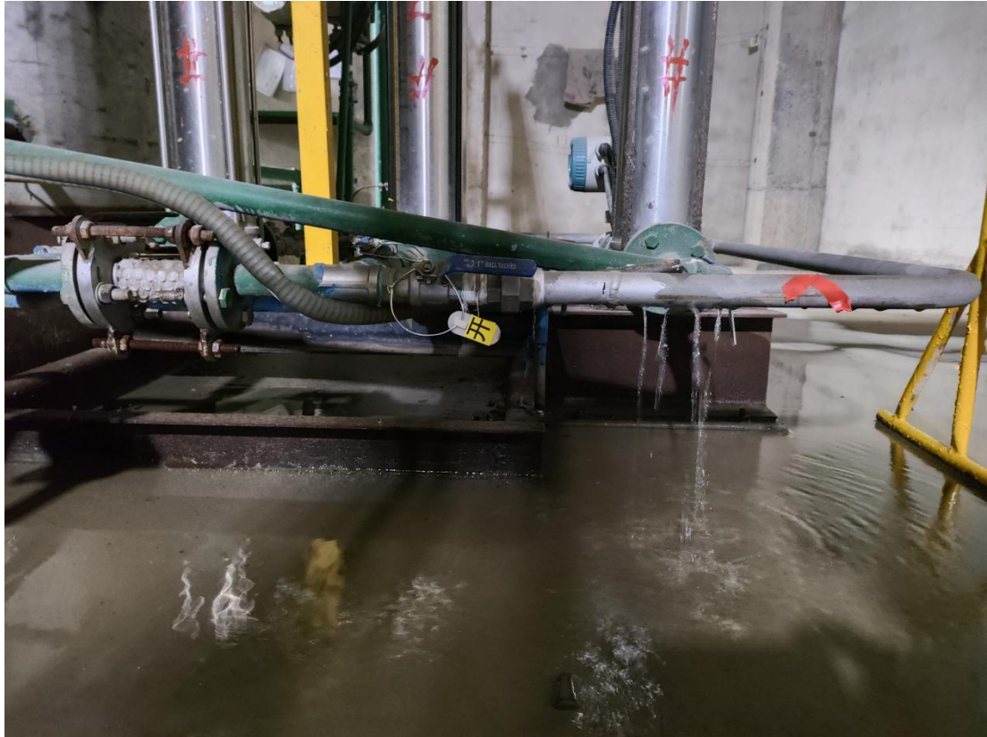
巡检人员发现氨水泄漏
